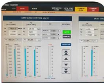
HMI کمپرسور ۱۵۷۱ محصول بخش CONTROL LOOPS KOBELCO
